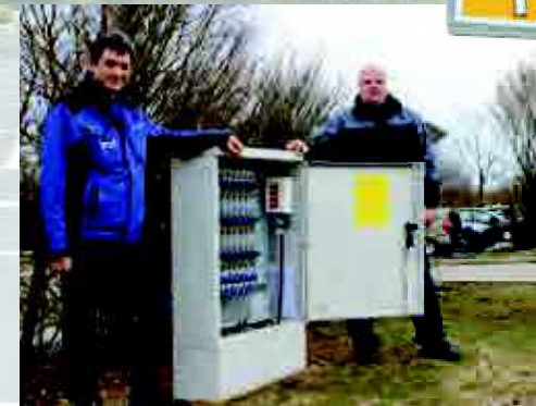
Verteiler für die vorgesehene Stromtankstelle
